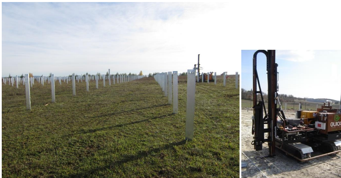
Illustration 23 : Exemple de pieux battus dans le sol avec une batteuse (Source : NEOEN)
