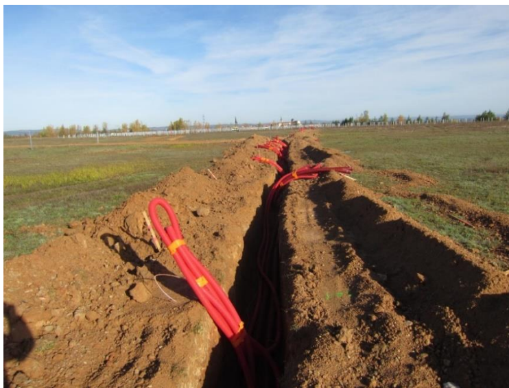
Illustration 22 : Exemple de tranchée et pose de câbles dans des fourreaux (Source : NEOEN)
