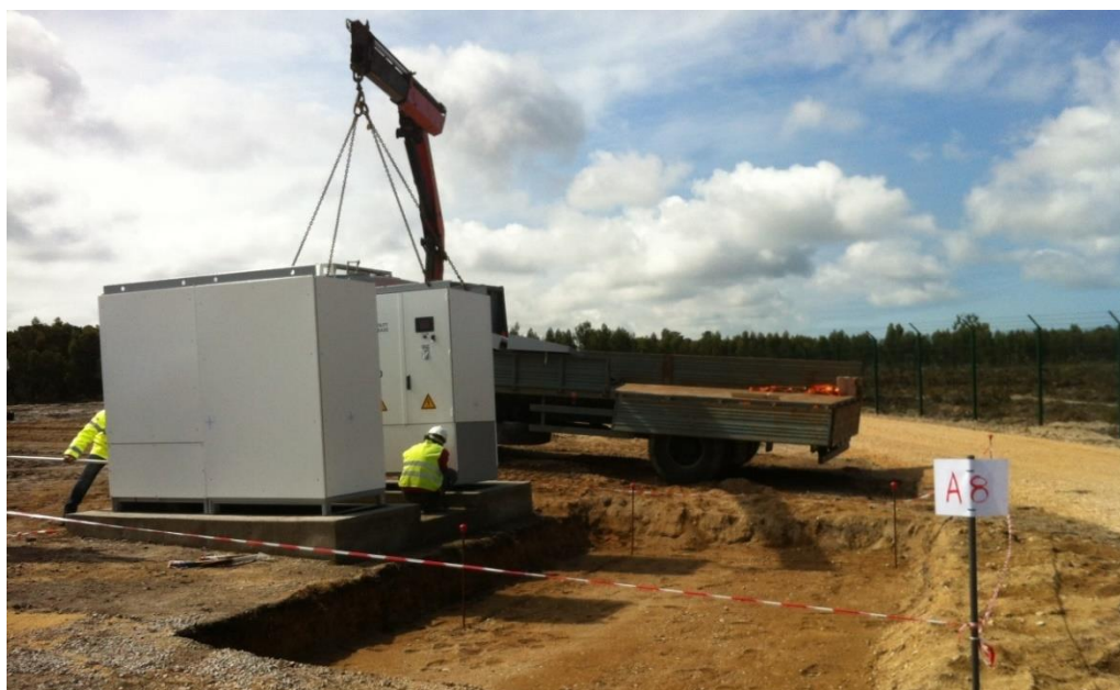
Illustration 26 : Exemple d'installation de poste de conversion outdoor (Source : NEOEN)
