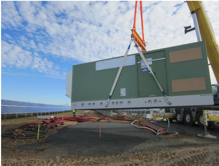
Illustration 27 : Exemple d'installation de poste de conversion (Source : NEOEN)
