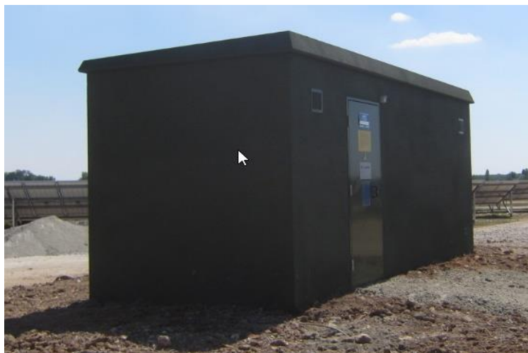
Illustration 28 : Exemple de poste de conversion « indoor »
