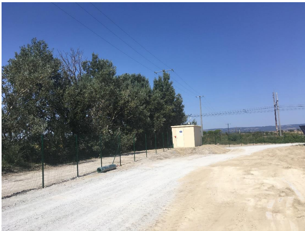
Illustration 30 : Exemple de poste de livraison (Source : NEOEN)
