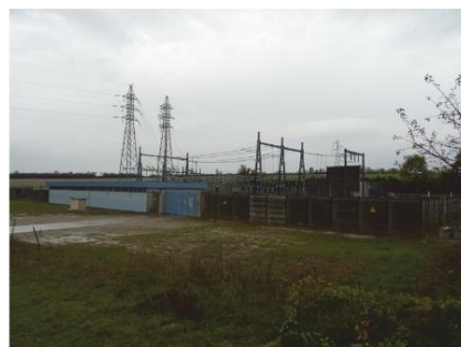
7 - Sous-station électrique Enedis
